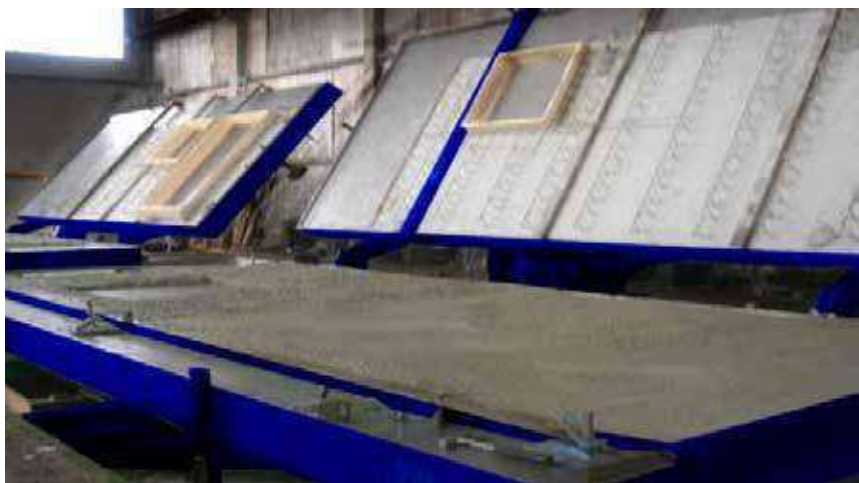
Оборудование в работе
